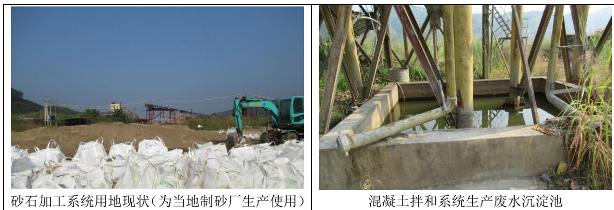
图 5.1-4 砂石加工系统和混凝土拌和系统设施情况
