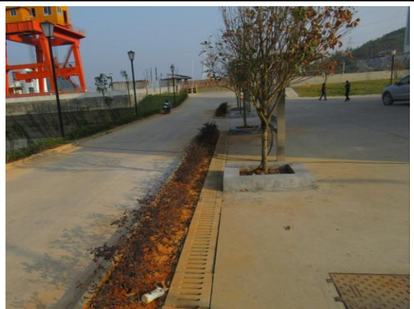
业主生活管理区排水沟现状-1
