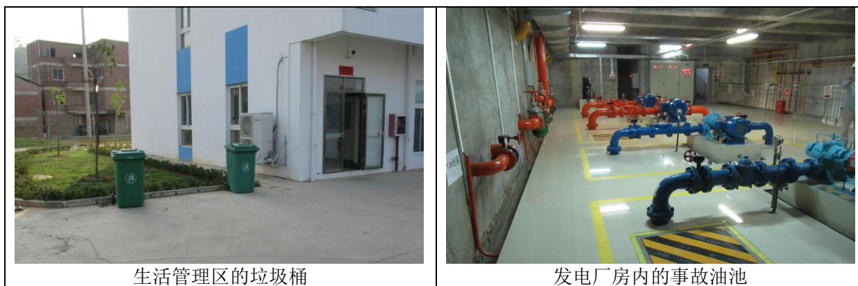
图 5.1-6 工程固体废弃物处置设施情况
