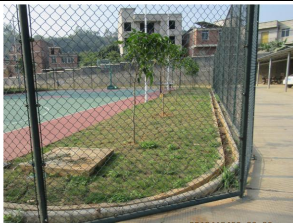
业主生活管理区排水沟现状-2
